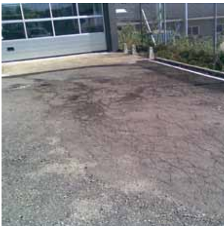
Billedet viser utæt belægning på en oplagsplads. Utæthederne giver risiko for forurening.
