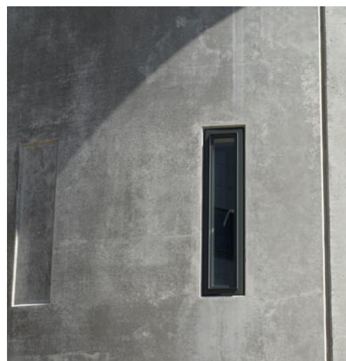
Eksempel på betonelement med synlige fuger - Tvillingsiloen for enden af Lindholm Brygge.
